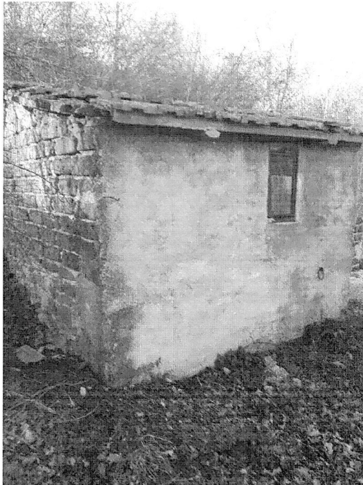
FOTO n. 21 – porcilaia edificata sull'IMMOBILE 2
