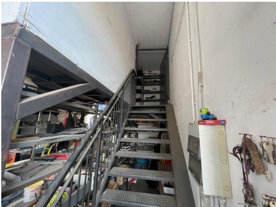
Scala di Accesso al soppalco non autorizzato
