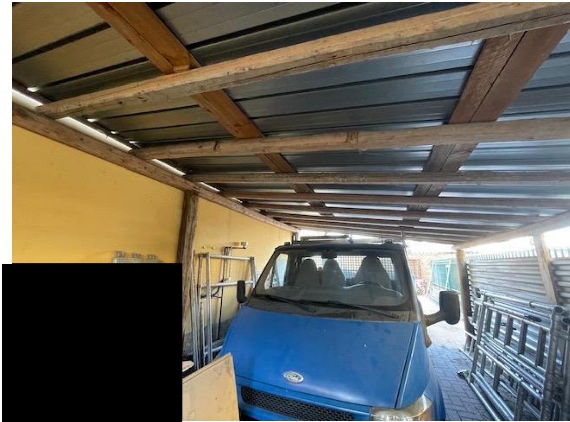
Cortile Area Esterna – Area Retro – particolare tettoia non autorizzata
