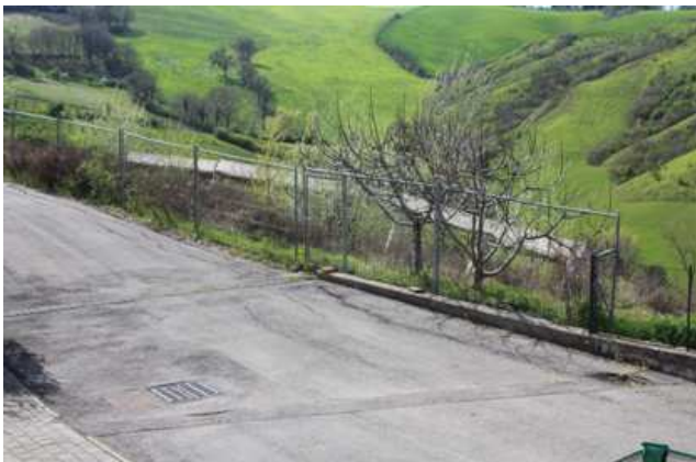
Foto 10: area di sosta collassata
