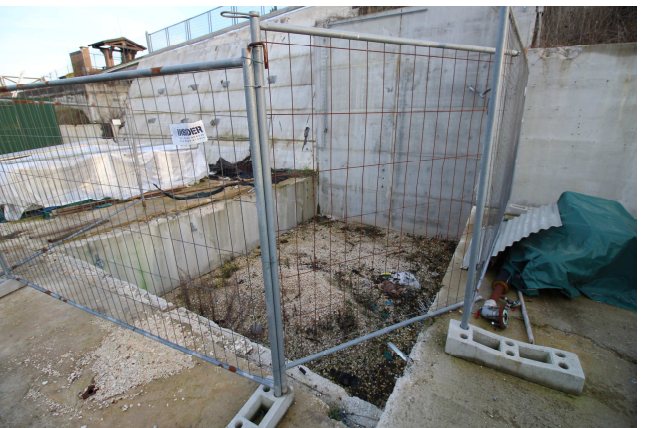
Foto 136: dettaglio fossa di carico materiale ligneo
