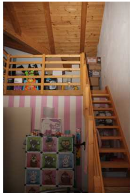
Foto 101: soppalco abusivo da camera da letto singola
