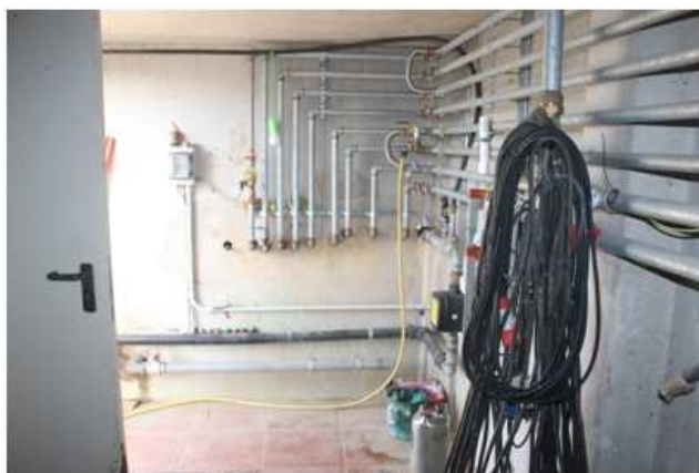
Foto 122: interno del locale tecnico
