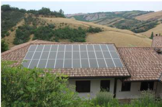
Foto 82: pannelli fotovoltaici in copertura agriturismo
