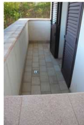
Foto 43: terrazzo con parte abusiva
