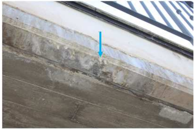
Foto 53: stalattiti di sottofondo percolato
