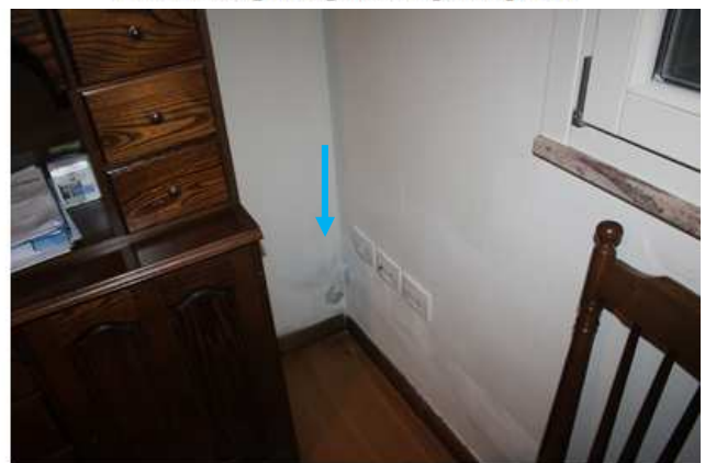
Foto 49: degrado da umidità alle pareti del soggiorno
