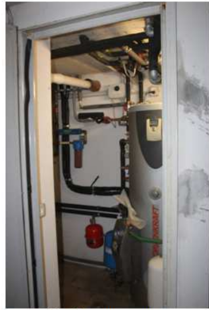
Foto 74: locale tecnico - interno
