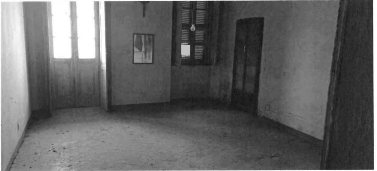
SUB 17 VISTA CAMERA CON PARTE SOFFITTO CROLLATO
