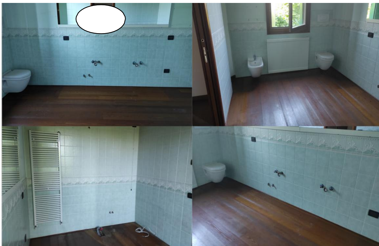
Fig.76-77-78-79- STATO BAGNO PADRONALE CAMERA DOPO ASPORTAZIONE MOBILIO -MAGGIO 2023
