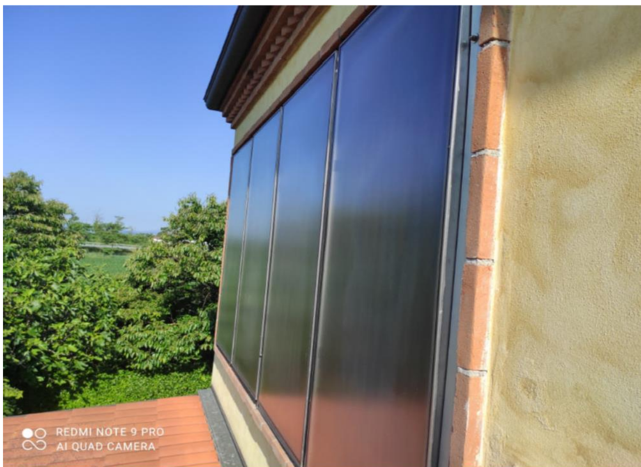
Fig.89- IMPIANTO FOTOVOLTAICO-PANNELLI SULLA PARETE SUD;
