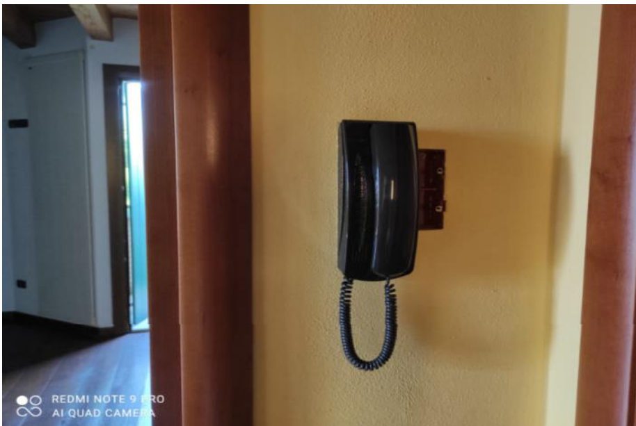
Figure 83-84-85- PIANO TERRA- STATO IMPIANTI IN CUCINA DURANTE SOPRALIOGO DEL 13 DICEMBRE 2022- STATO IMPIANTI IN CUCINA DOPO ASPORTAZIONE MOBILIO-MAGGIO 2023;
