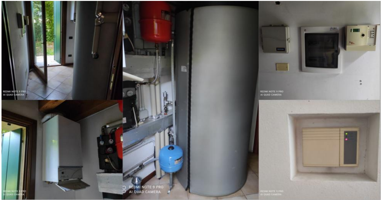
Figure 38-39-40-41-42- PIANO TERRA-STATO LOCALE IMPIANTI DOPO ASPORTAZIONE MOBILIO -MAGGIO 2023;
