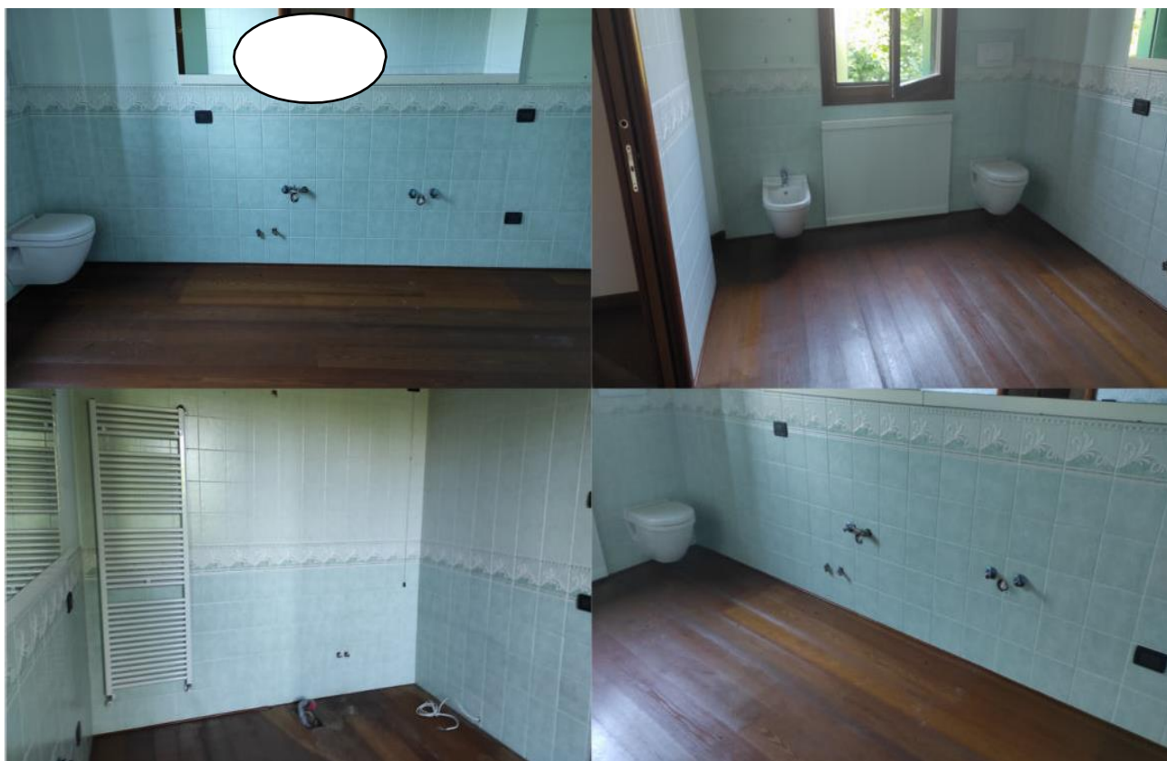
Fig.78-79-80-81- STATO BAGNO PADRONALE CAMERA DOPO ASPORTAZIONE MOBILIO -MAGGIO 2023;
