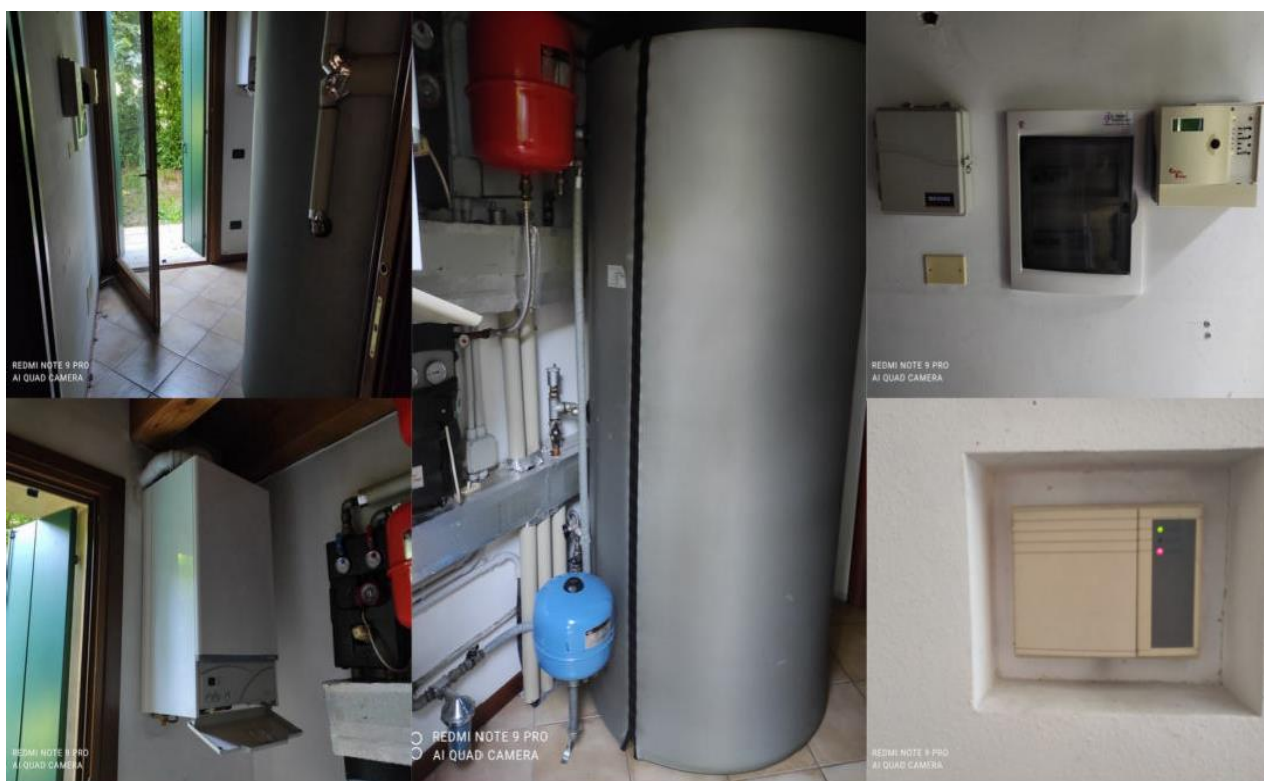
Figure 42-42°-43-44- 44°- PIANO TERRA-STATO LOCALE IMPIANTI DOPO ASPORTAZIONE MOBILIO -MAGGIO 2023
