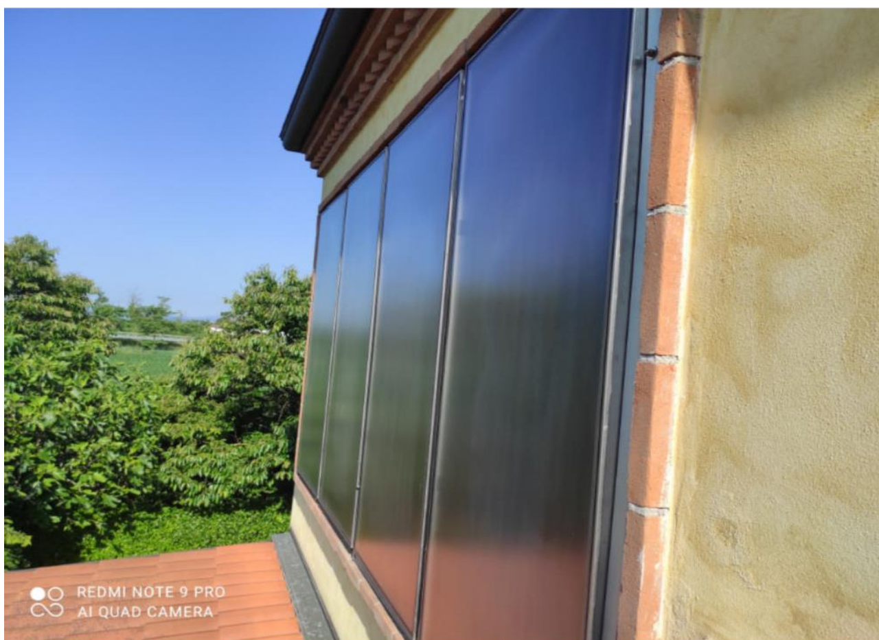
Fig.90- IMPIANTO FOTOVOLTAICO-PANNELLI SULLA PARETE SUD;
