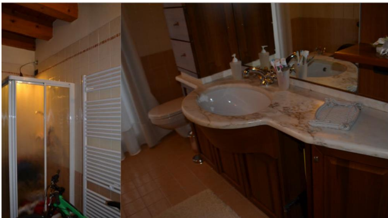
Fig.66-67- 1° PIANO - STATO BAGNO ALLA DATA DEL SOPRALLUOGO 13 DICEMBRE 2022;
