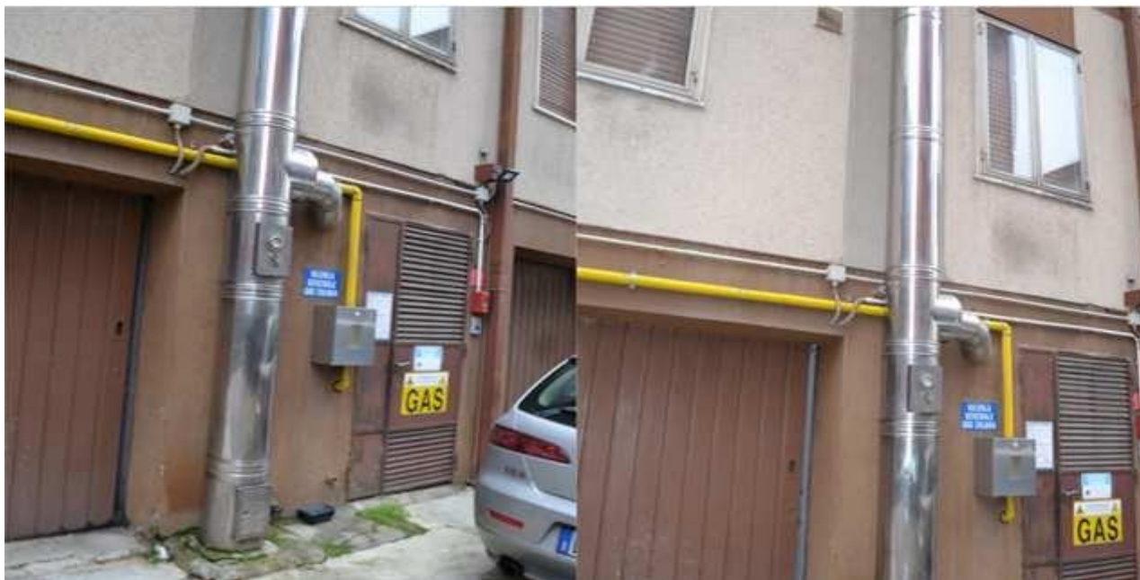
Figure 58-59-Vano caldaia condominiale centralizzata.
