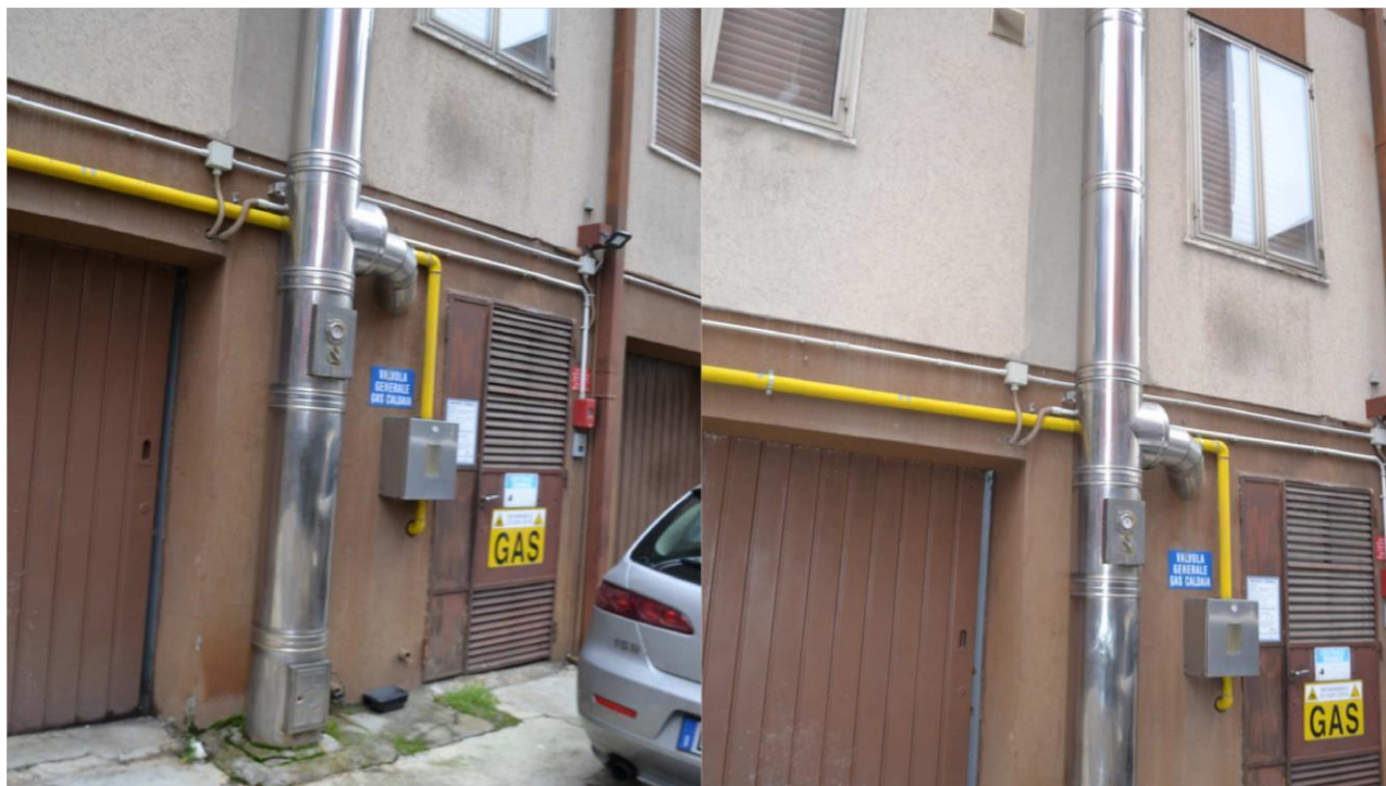
Figure 71-72-Vano caldaia condominiale centralizzata.
