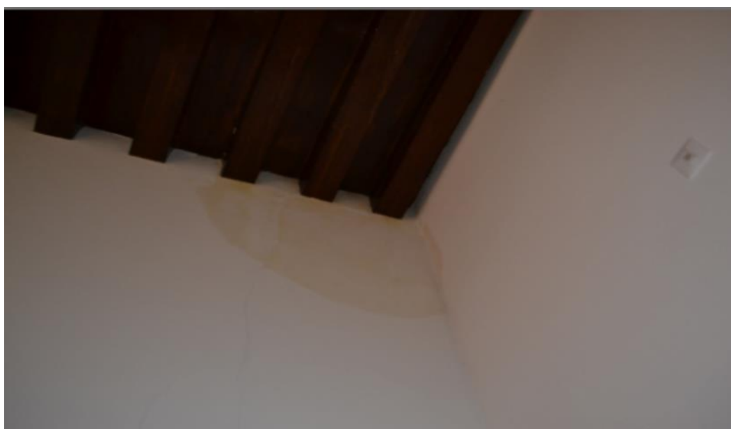
Fig.58-Macchia dovuta ad infiltrazione dal piano superiore e crepa;
