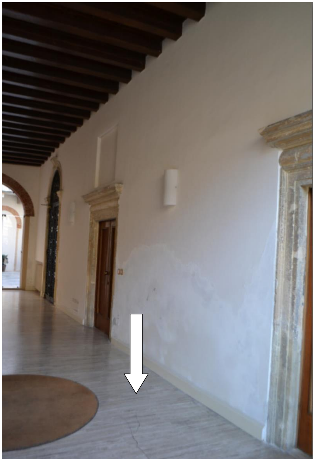
Figura 10 - Androne (pavimento in marmo crepato vistosamente).
