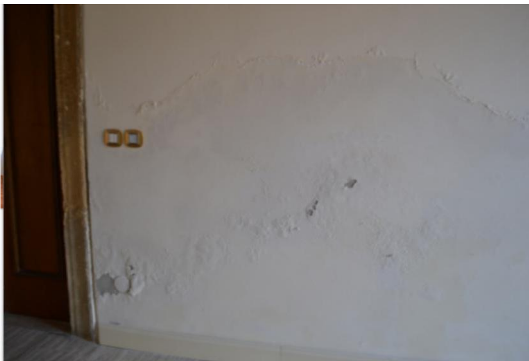
Figura 9 - Androne problema umidità da risalita capillare- presenza sali.
