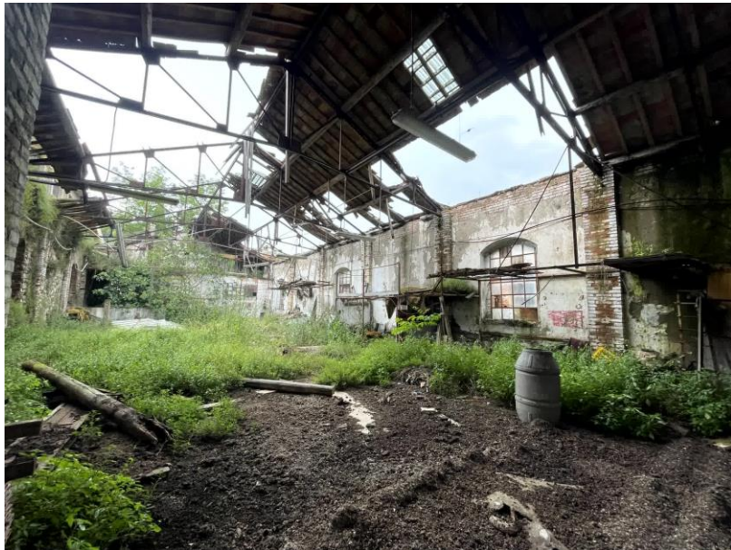
Foto n. 17 - Porzione di fabbricato diruta
