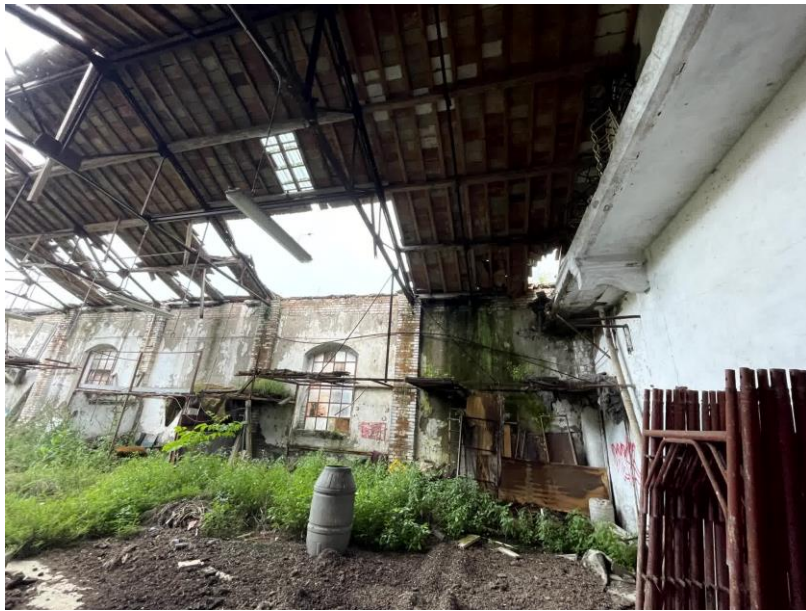
Foto n. 16 - Porzione di fabbricato diruta
