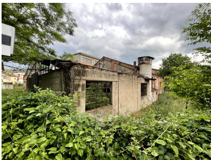
Foto n. 11 -Porzione di fabbricato diruta e corte esclusiva
