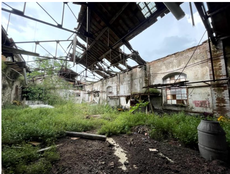
Foto n. 14 - Porzione di fabbricato diruta
