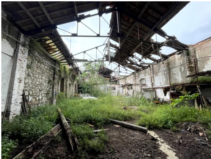
Foto n. 15 - Porzione di fabbricato diruta
