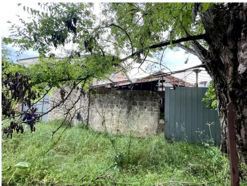
Foto n. 10 -Porzione di fabbricato diruta e corte esclusiva
