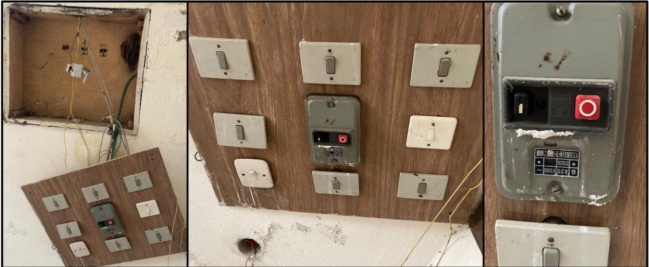
Impianto elettrico: dettagli
