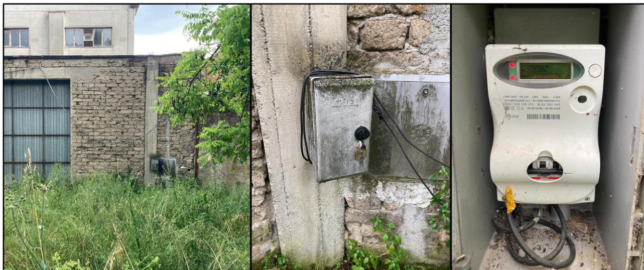
Impianto elettrico: punto di fornitura con alloggiamento contatore e differenziale
