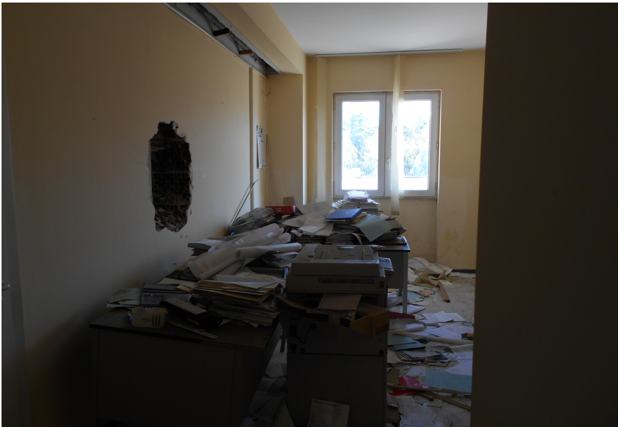
↓ Foto n° 8 - Pareti parzialmente demolite . Stato fatiscente dei locali.
