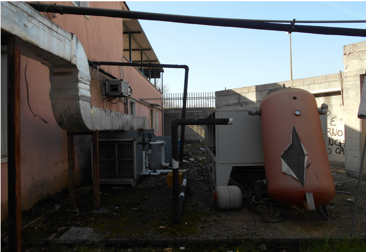
↓ Foto n° 6 - Servizi quali impianti di condizionamento, autoclave etc. al piano seminterrato del Poliambulatorio
