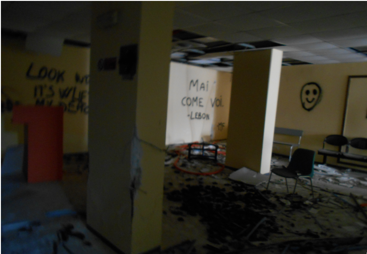
↑ Foto n° 9 - Controsoffitto divelto . Materiali distrutti . Atti di vandalismo
