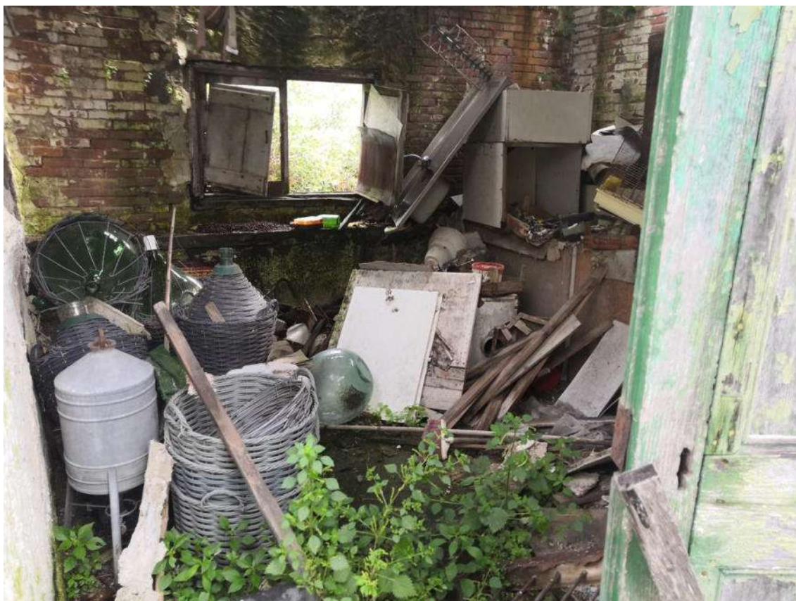
Foto 12 FABBRICATO PART. 880 – DIRUTO –
