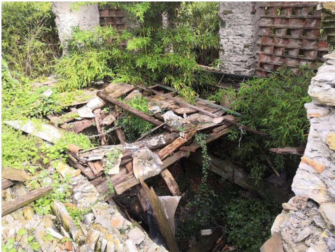
Foto 11 FABBRICATO PART. 880 – DIRUTO –
