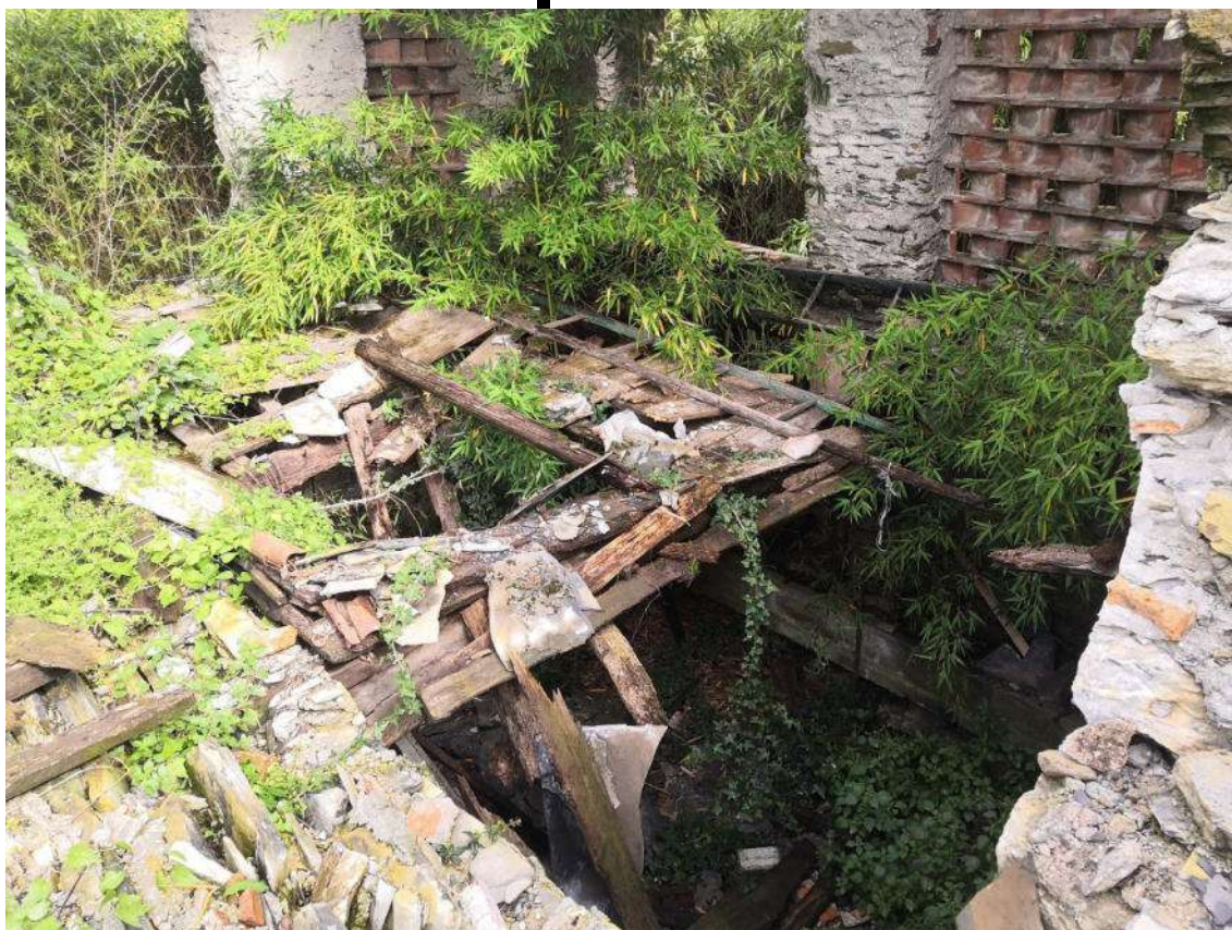
Foto 6 FABBRICATO PART. 880 DIRUTO
