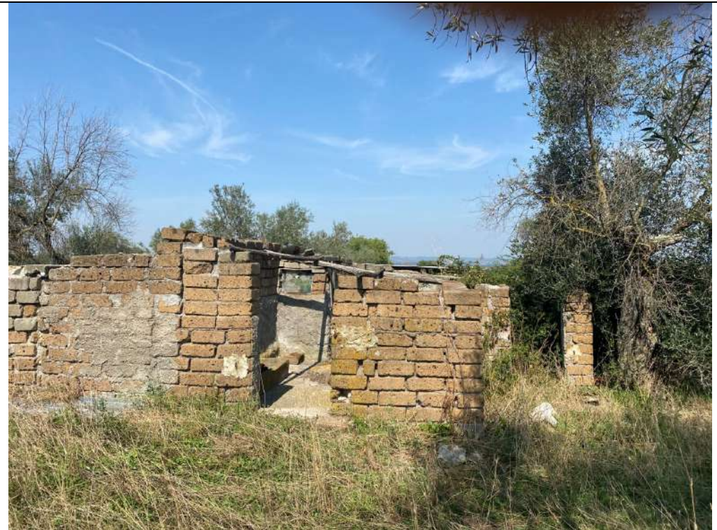
Vista manufatto collabente
