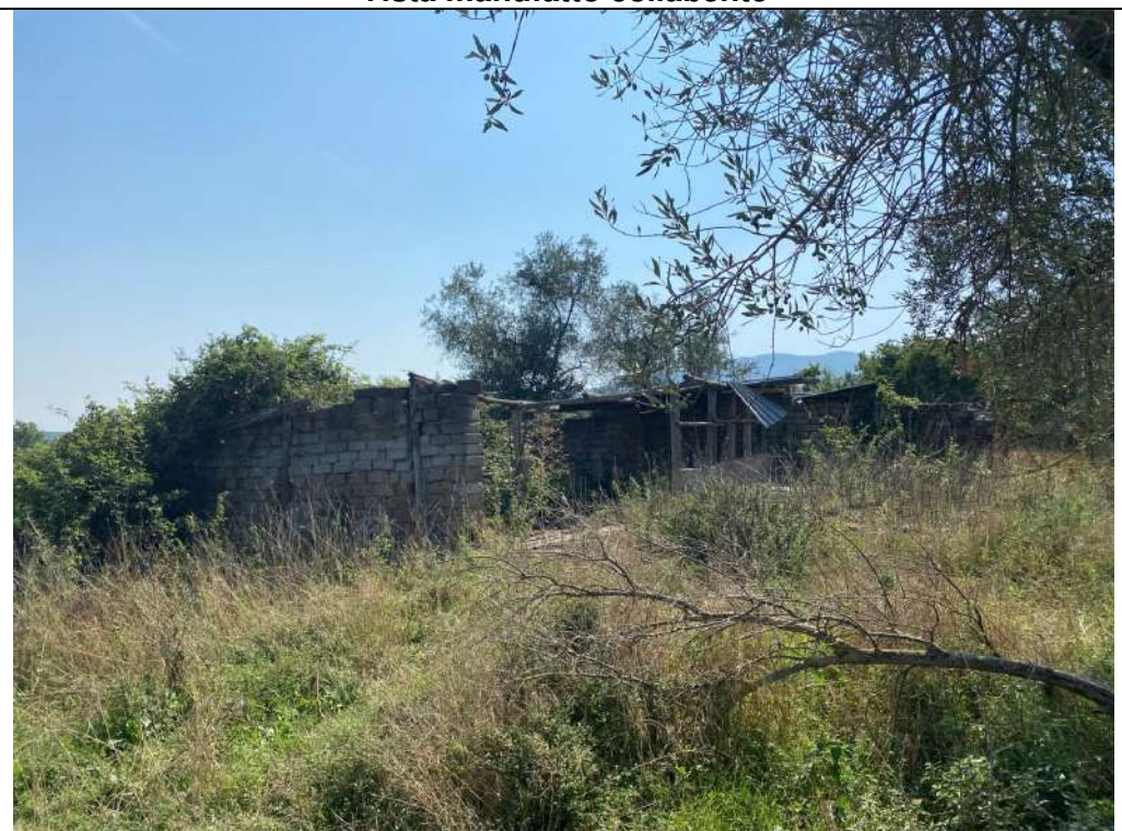
Vista manufatto collabente
