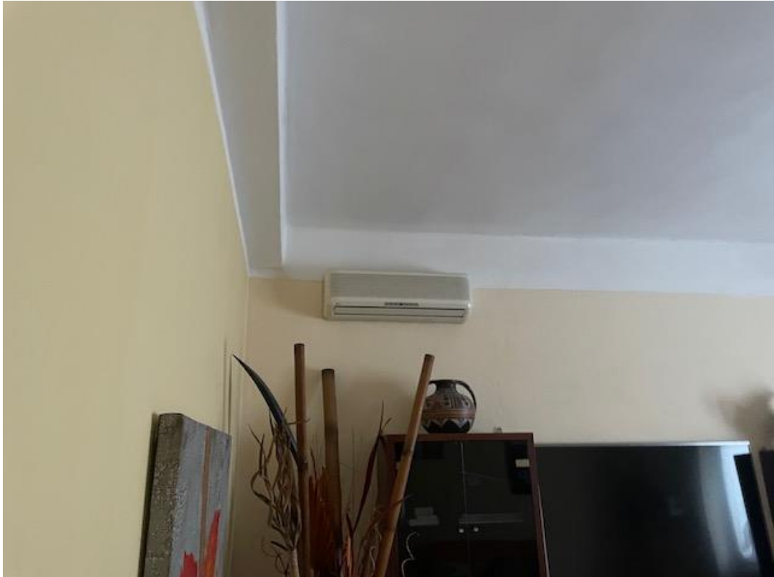
SOGGIORNO – adibita a soggiorno – particolare CDZ Split
