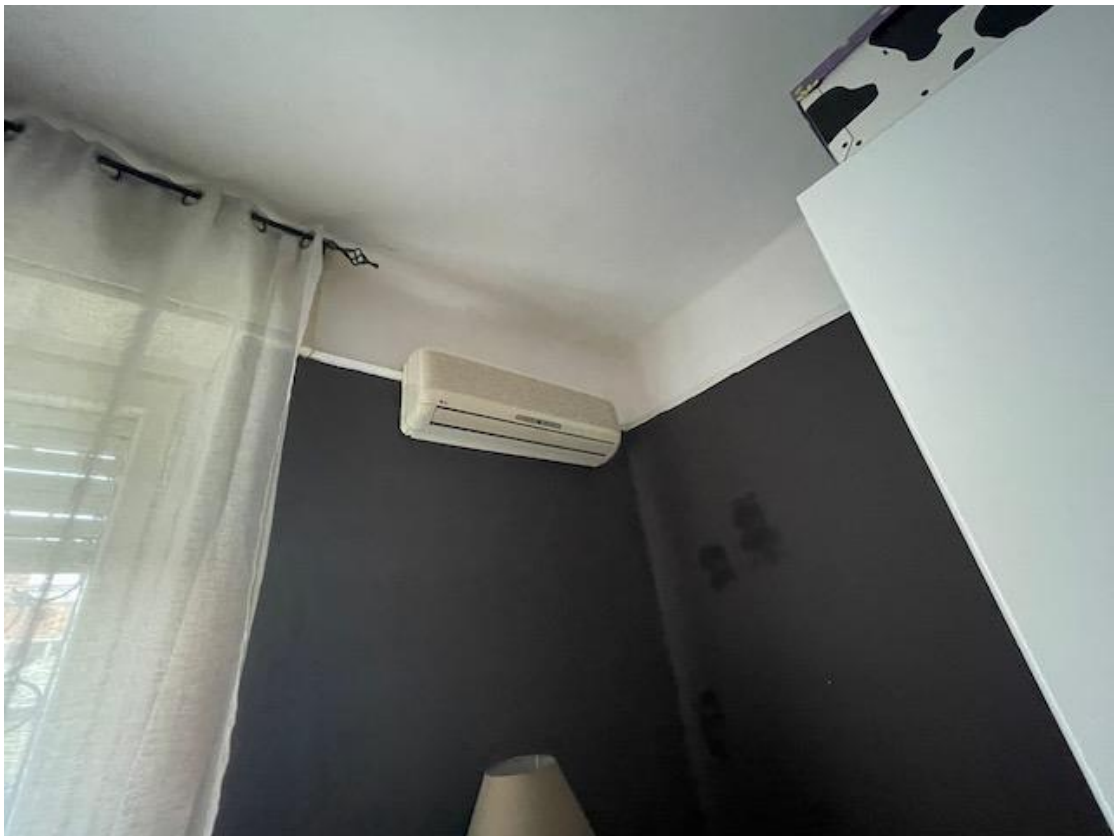
CAMERA n.2 – particolare split CDZ
