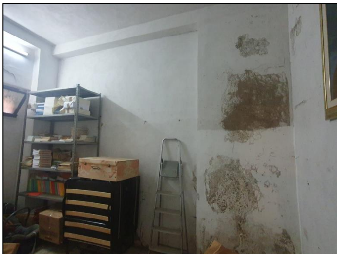
Foto 23– Tracce di infiltrazioni sul pilastro
