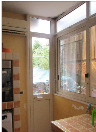
Foto 19 – tracce di umidità da condensa
