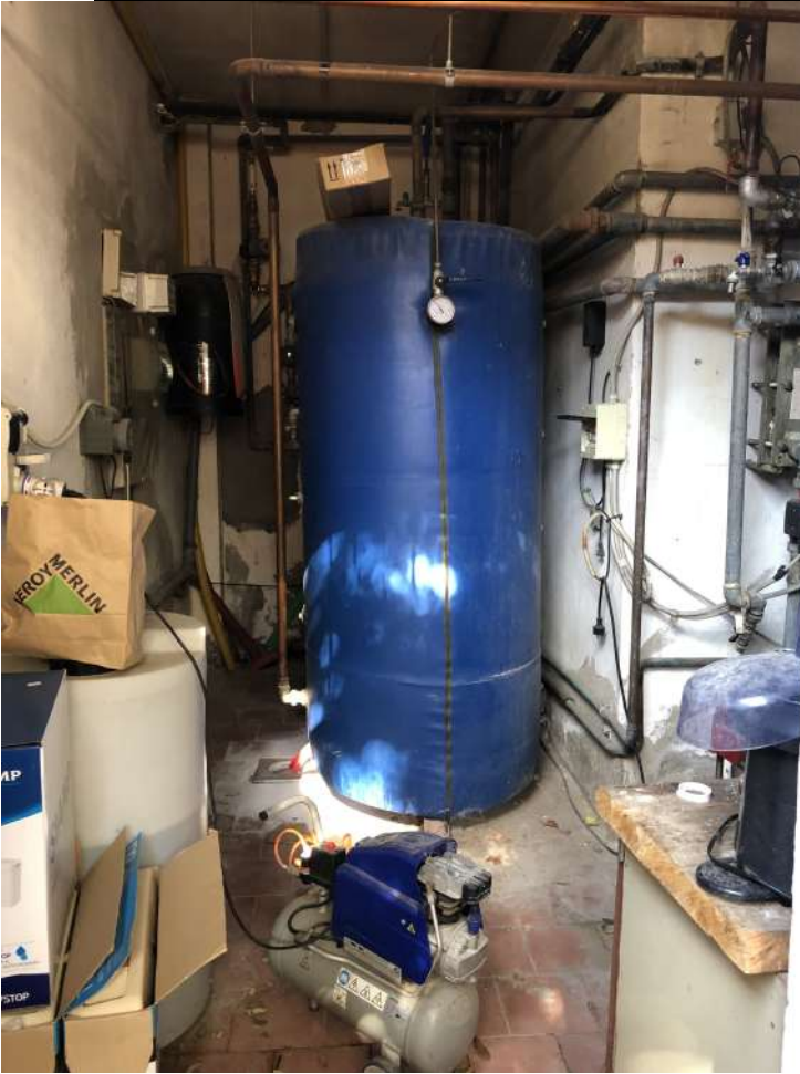
Foto 21- Locale Tecnico (C.T.)
