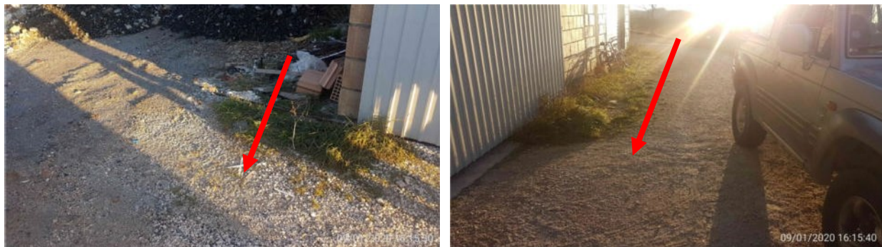
Foto 3.4.1.1 – Passaggio condotta adduttrice interrata
