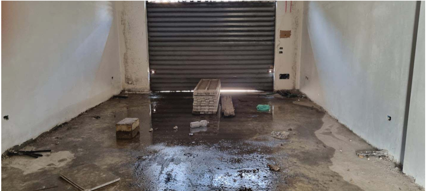
Punto di ristagno dell'acqua
