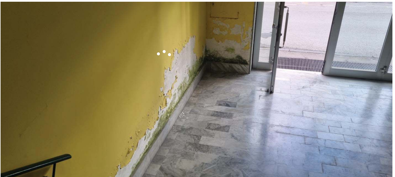
Presenza di muffa parete androne fabbricato
