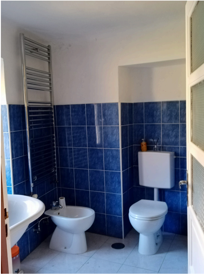
FOTO 11 - 12 – Bagno (piano secondo)
