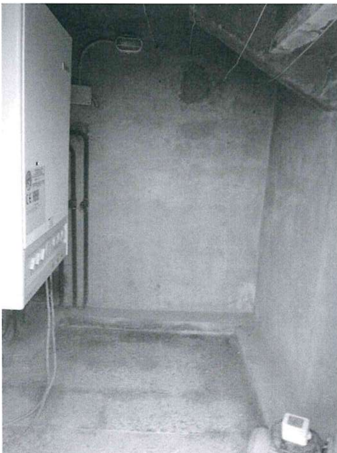
Foto 15: vano sottoscala utilizzato per l'alloggiamento della caldaia
