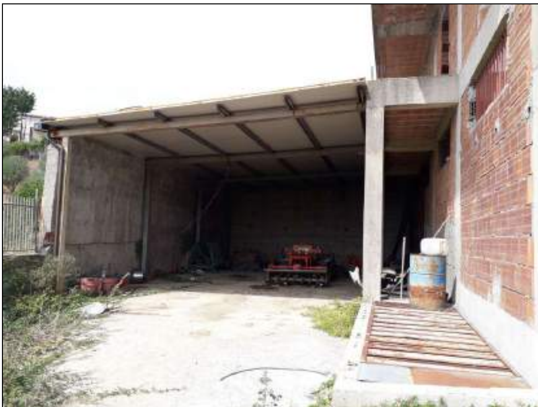
Foto N.4: Prospetto Ovest dell'immobile oggetto di stima con tettoia in metallo da demolire
