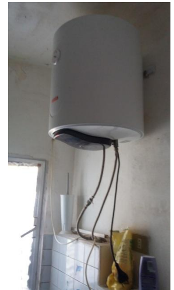
Foto 21 – Boiler elettrico ACS
