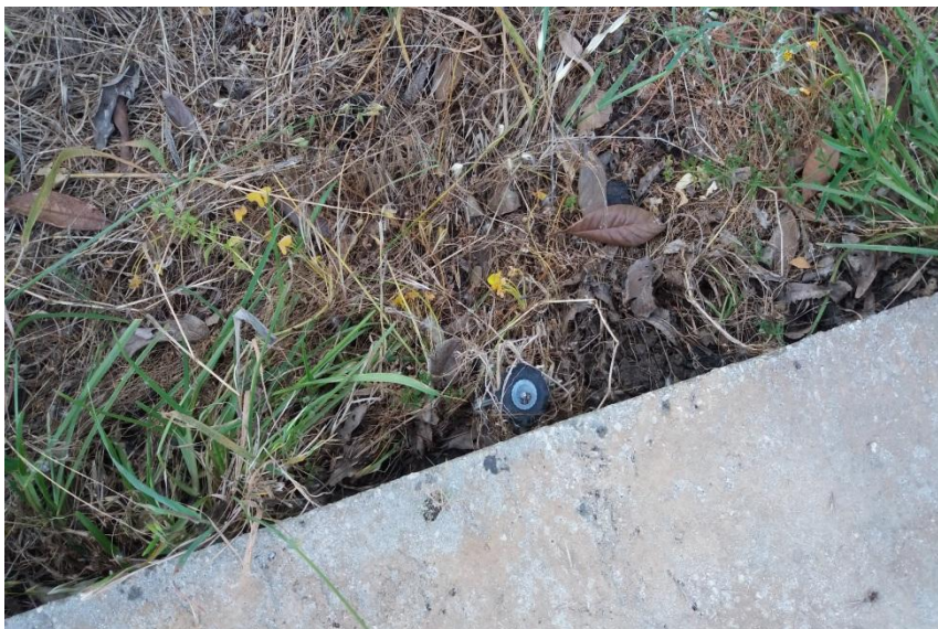
Foto 30 – Sistema di irrigazione interrato
