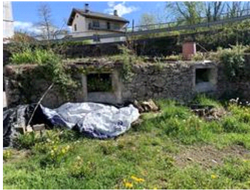
Fabbricato collabente (m.le 433).
