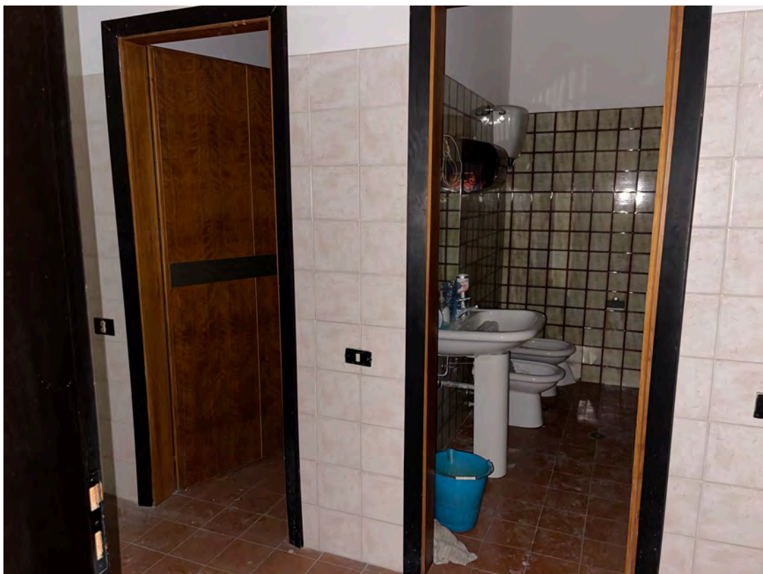
Foto 26 WC P.T.-rialzato fg. 18 - p.lla 201 NTC Fg. 7 p.lla 1121
