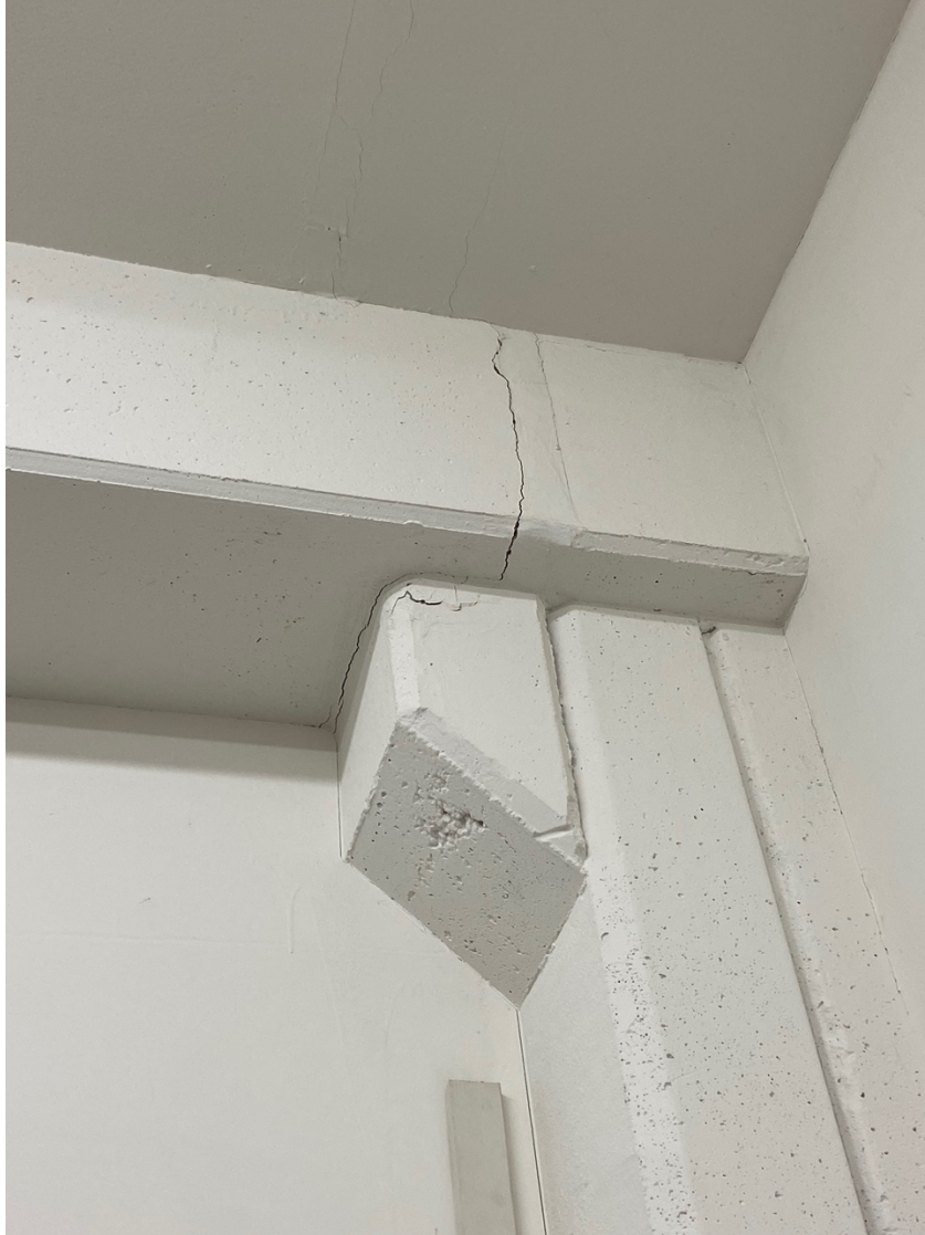
Figura 2. – LOTTO 2 – Lesione agli appoggi tra trave e pilastro in c.a.p. – lesione non strutturale su giunto
