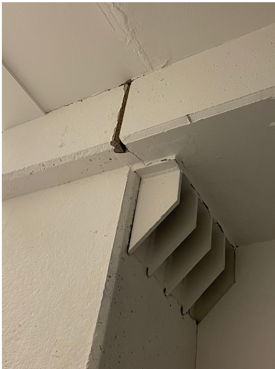
Figura 3. – LOTTO 2 – Lesione agli appoggi tra trave e pilastro in c.a.p. – lesione non strutturale su giunto
