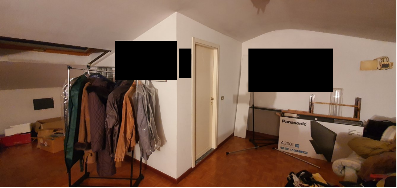
FOTO - vista ingresso bagno nel sottotetto, sulla destra a parete quadro elettrico
