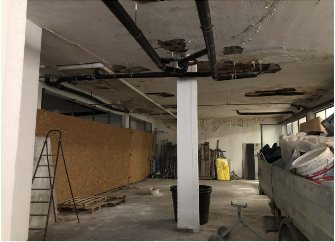
Foto 5 – vista interna – zona con infiltrazioni
