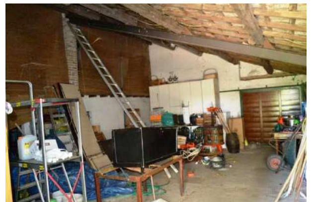
foto 31 - scorcio del magazzino rustico a nord est della villa con tetto in legno da riparare
