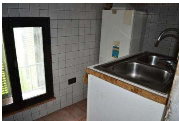
foto 28 - l'angolo cottura con caldaia murale a sud est del piano 2° sottotetto
