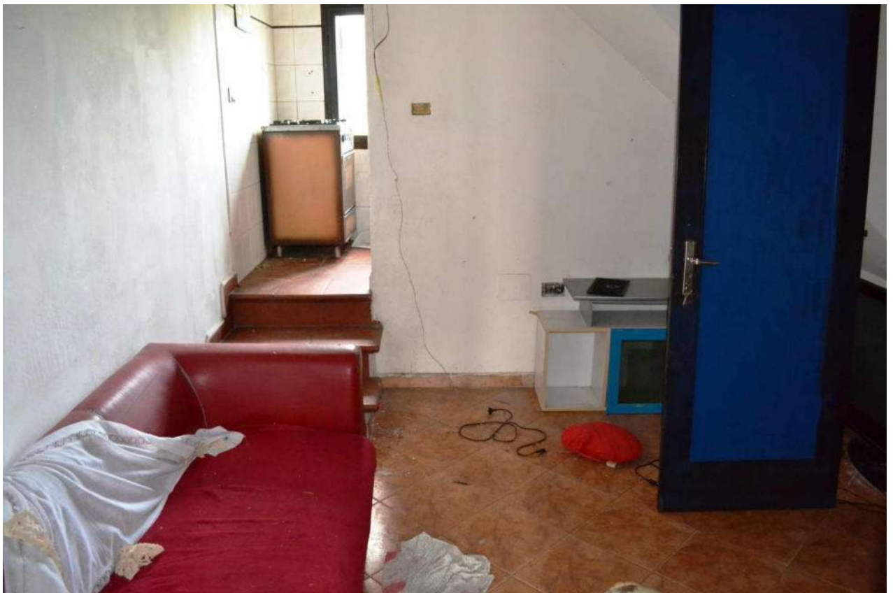
foto 23 – ABITAZIONE m.n. 533 sub 2, piano 1° - vista da nord dell'ingresso dal vano scala (porta a destra della foto) del monolocale spartito a piano 1°, con l'angolo cottura a sud est in posizione di antibagno, incompatibile con i minimi requisiti igienico-sanitari vigenti e quindi da ripristinare secondo il progetto autorizzato o con soluzioni conformi ai criteri di norma
