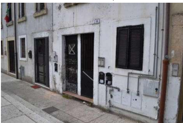
foto 14 - scorcio dell'ingresso spartito con le adduzioni del gas a ciascuno dei piani
