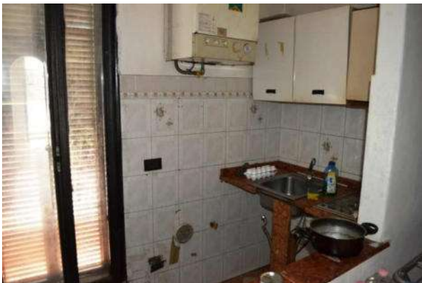
foto 21 - l'angolo cottura sud est con la caldaia a parete da verificare e la porta del terrazzo
