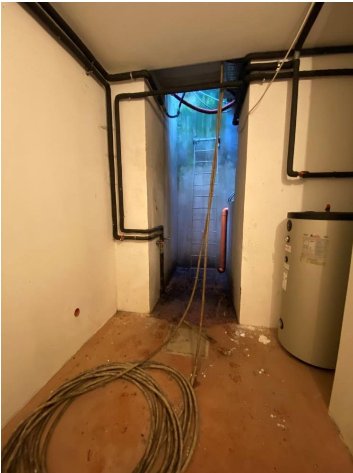
Foto n. 64 – Piano interrato - Vista del locale in fondo a sinistra dove si evidenzia uno scoperto con a destra una galleria dove sono gli impianti che portano alla villa principale
