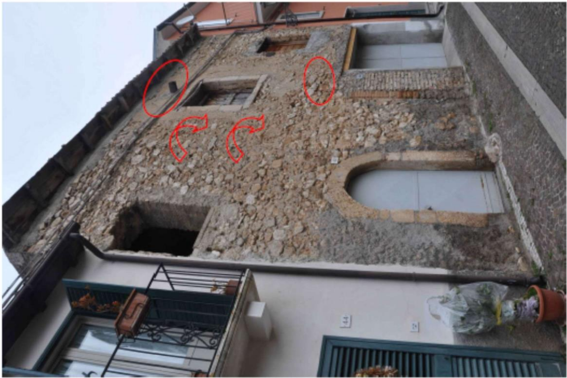
Foto 27: lesioni sulla muratura e principio di ribaltamento della stessa
