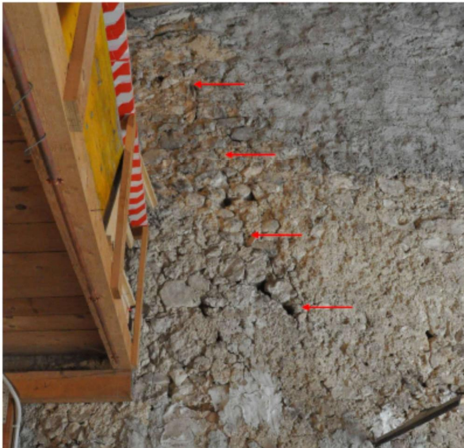
Foto 28: lesioni sulla muratura
