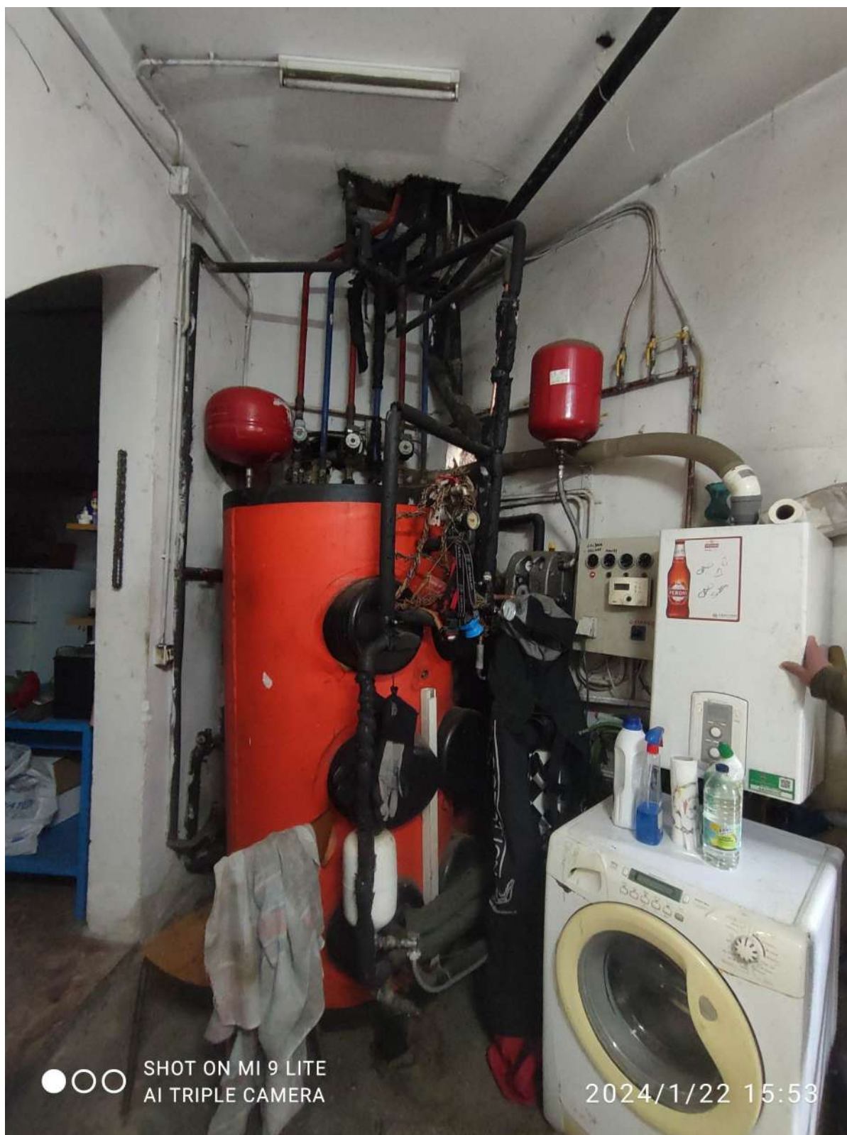
Figura 26: cantina-portico utilizzata come locale caldaia - piano sottostrada.
