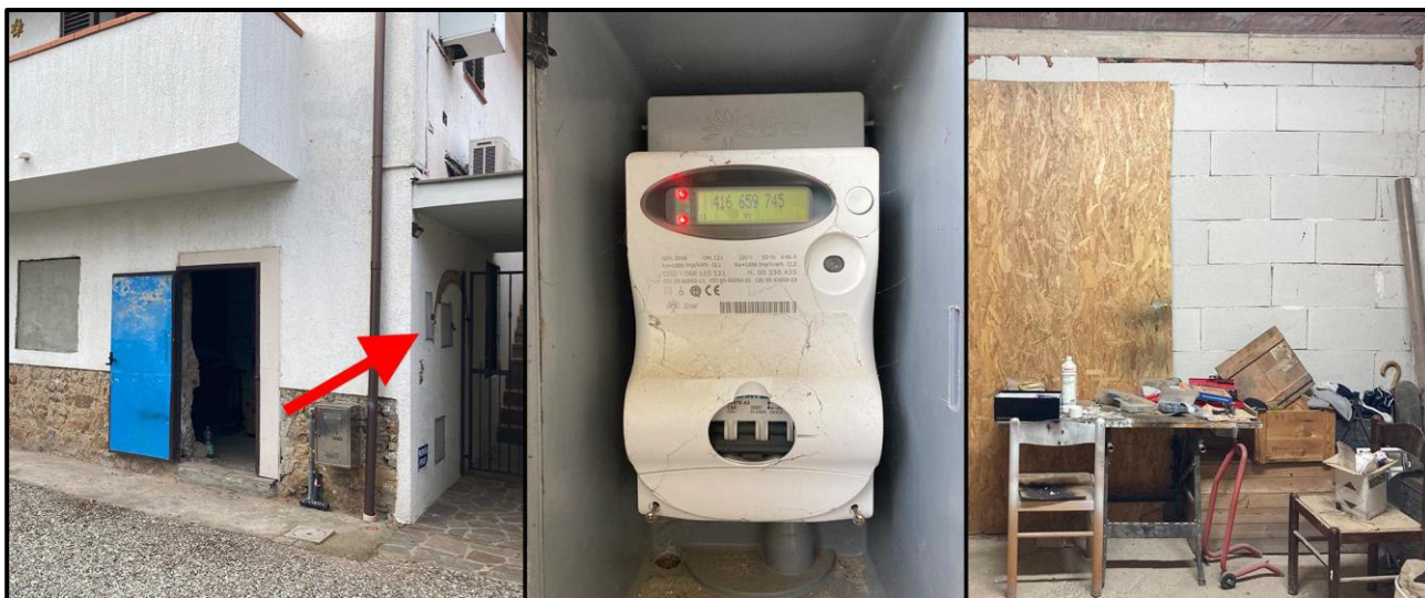
Impianto elettrico: punto di fornitura con alloggiamento contatore, e situazione degli interni
