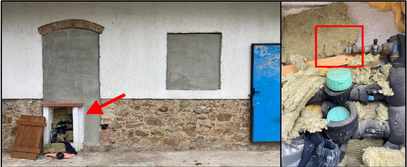
Impianto idrico: punto di fornitura e alloggiamento contatori
