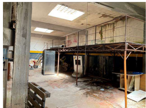
FOTO 18 – piccolo soppalco in acciaio
