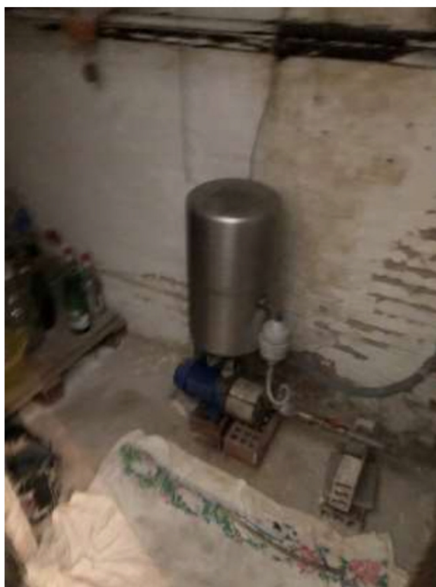
Foto 6: interno locale tecnico in PT
