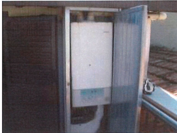
CALDAIA RISCALDAMENTO AUTONOMO PER PIANO SECONDO
