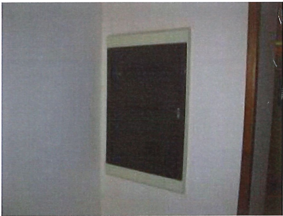
QUADRO ELETTRICO GENERALE
