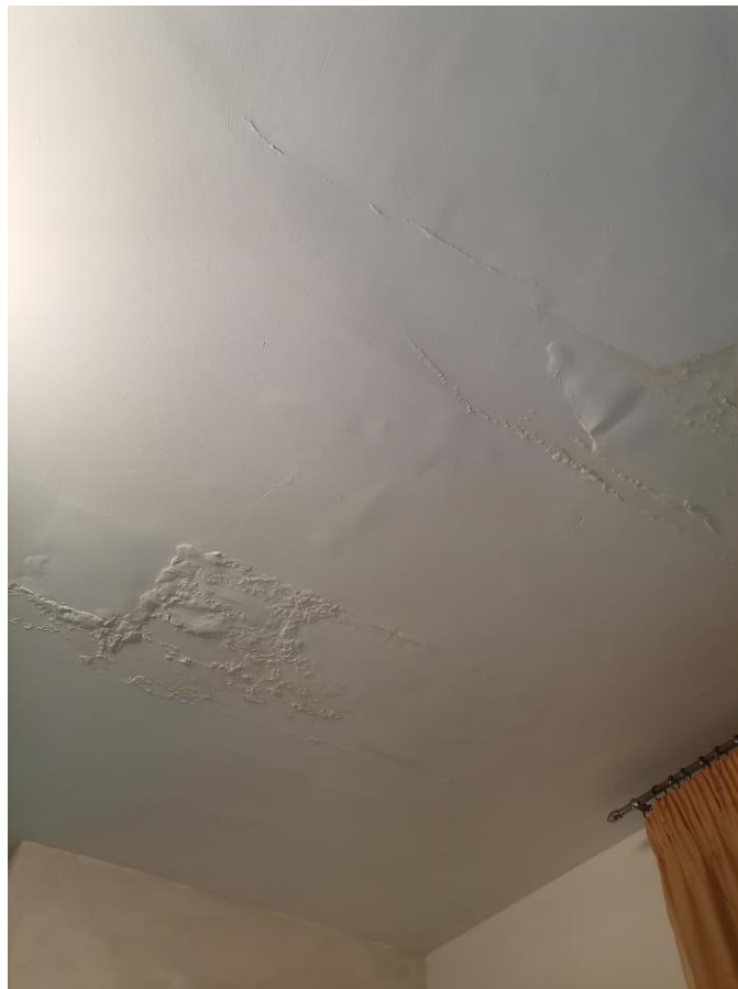
Foto n. 36: Infiltrazioni d'acqua dalla copertura nel soggiorno
