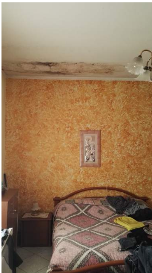
La camera da letto con infiltrazioni e muffa, dell'abitazione al lotto 2 p.la 307 sub 5
