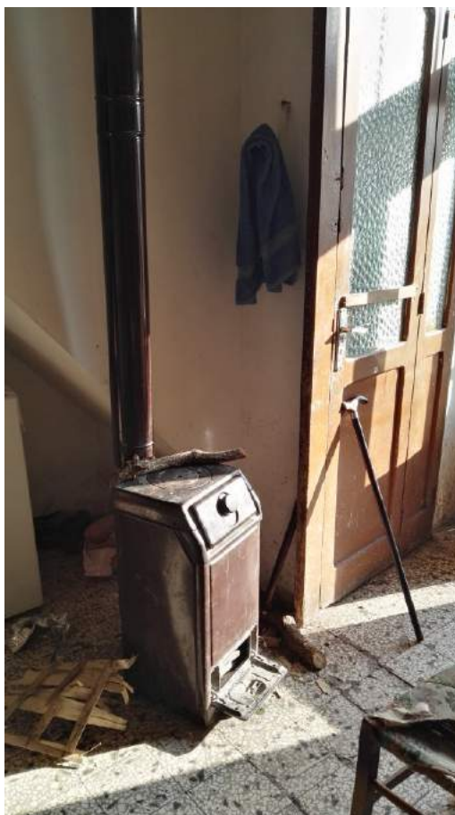
Il riscaldamento con stufa a legna dell'abitazione al lotto 2 p.la 307 sub 4
