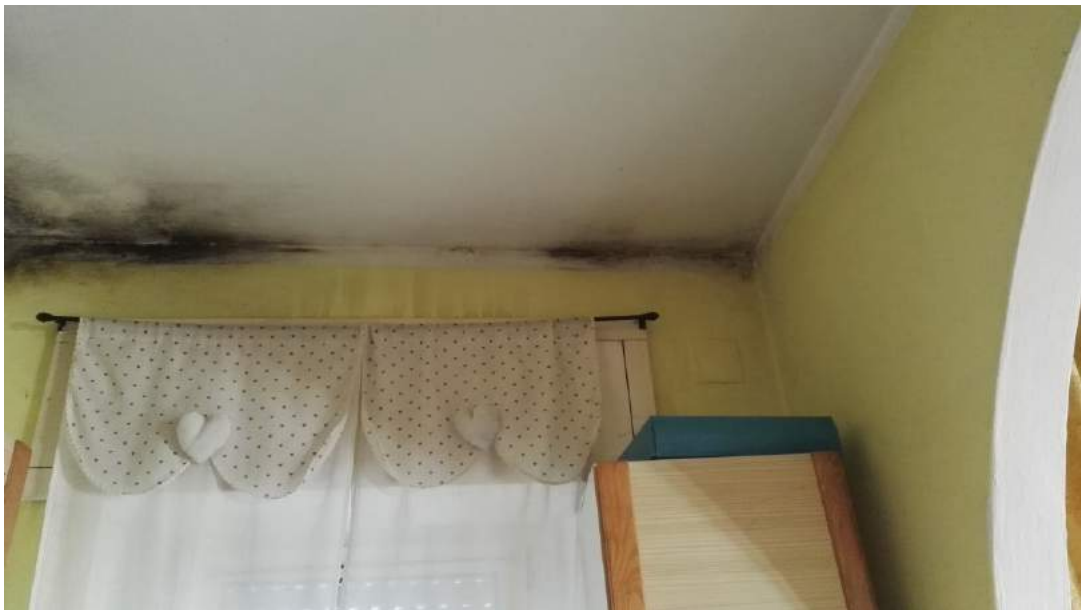
Infiltrazioni e muffa nella cucina dell'abitazione al lotto 2 p.la 307 sub 5
