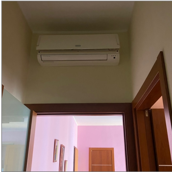
FOTO 18. Split aria condizionata zona notte
