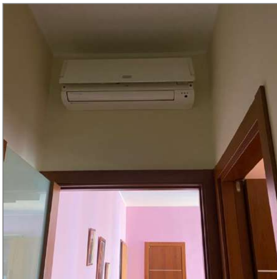
Split aria condizionata zona notte
