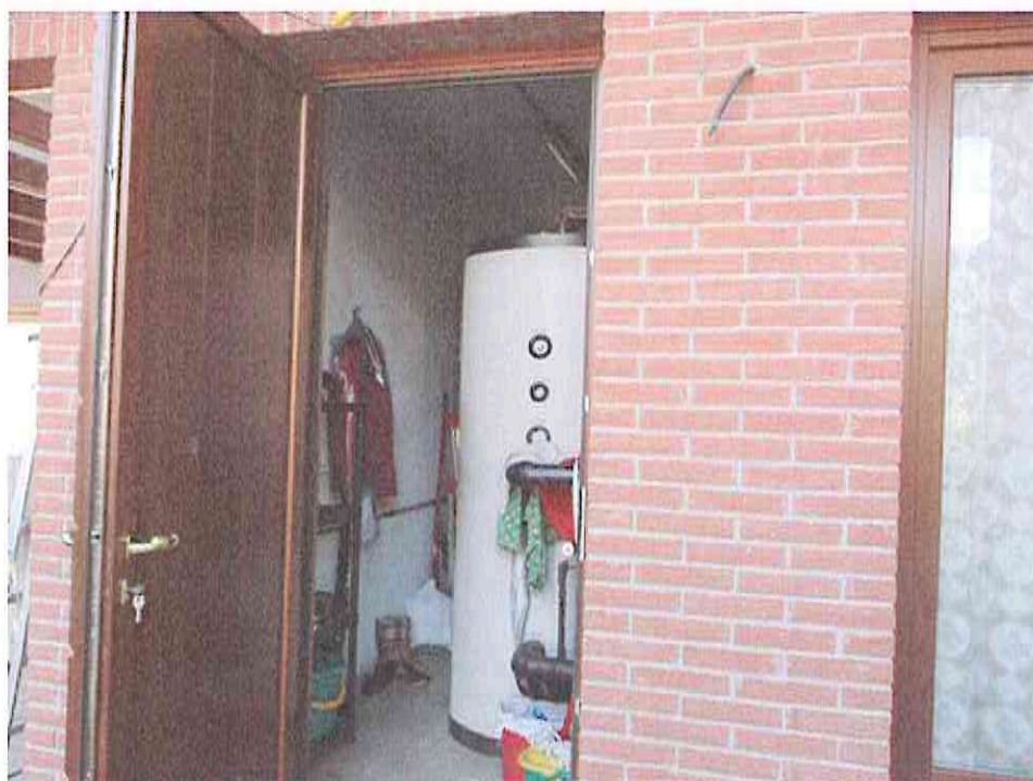
Foto 24 – Vista interna centrale termica
