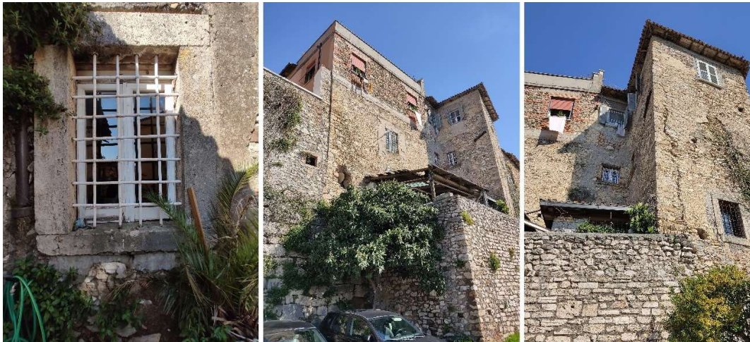
1-2) Finestra dell'ambiente Ufficio1 affacciata su vicolo Raonio 3) Vista dell'immobile da via Antico Tempio
