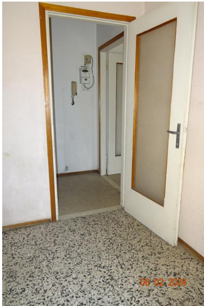
Tutti i serramenti sono in pessime condizioni
