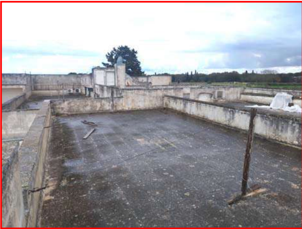
Foto 25 - Lotto 1 – Corpo B - frantoio – lastricato solare
