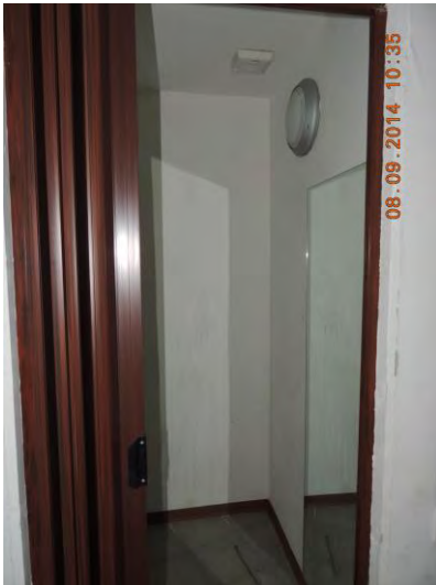
Foto n.10 – Infissi in pvc
