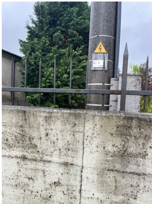
FOTOGRAFIA 6: LINEA ELETTRICA PASSANTE NEL GIARDINO LOTTO 1
