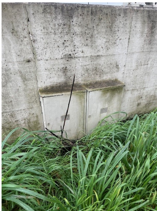
FOTOGRAFIA 4 : CASSETTE DEL GAS ESITENTI ESTERNE AL MURO DI RECINZIONE LUNGO VIA PAROLARA
