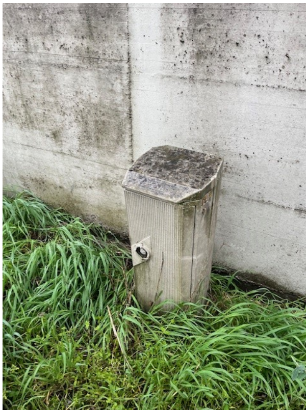
FOTOGRAFIA 3 : CASSETTA TELEFONICA ESTERNA AL MURO DI RECINZIONE LUNGO VIA PAROLARA
