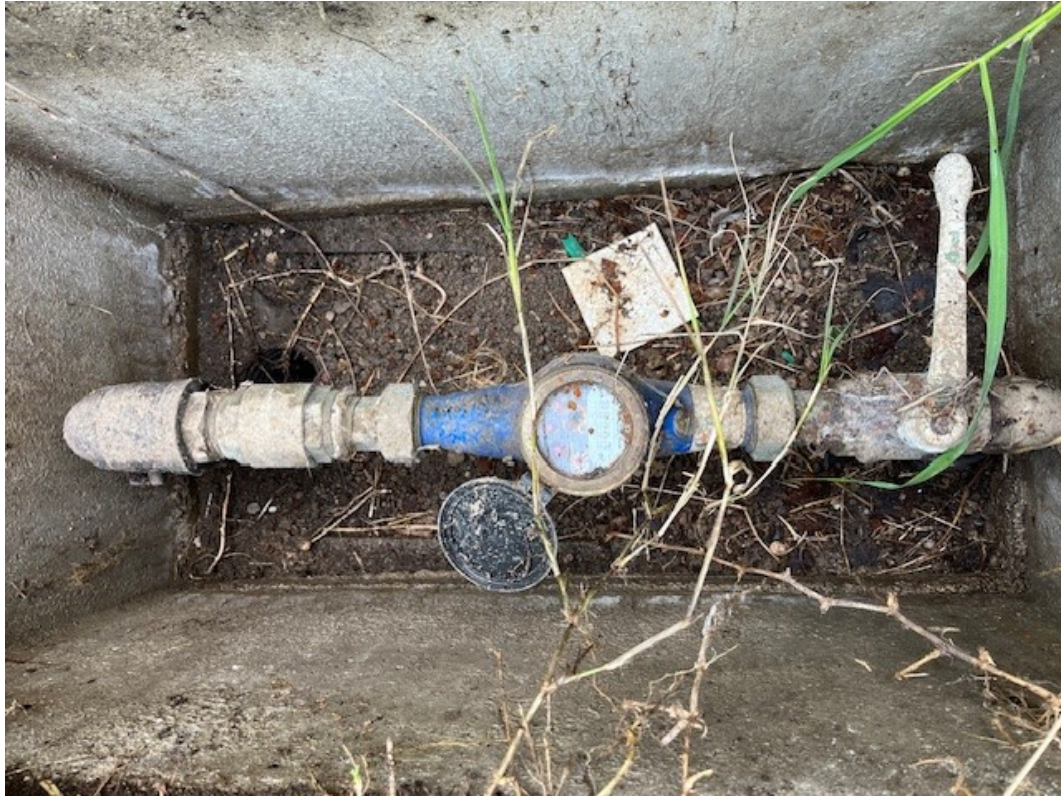
FOTOGRAFIA 5: CONTATORE ACQUA ESISTENTE IN POZZETTO ESTERNO AL MURO DI RECINZIONE LUNGO VIA PAROLARA
