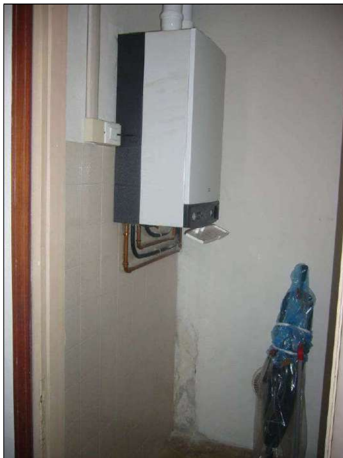
Fotografia 49- Vista scaldacqua bagni
