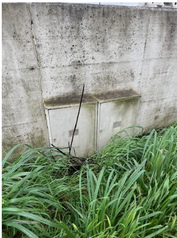
FOTOGRAFIA 4 : CASSETTE DEL GAS ESITENTI ESTERNE AL MURO DI RECINZIONE LUNGO VIA PAROLARA
