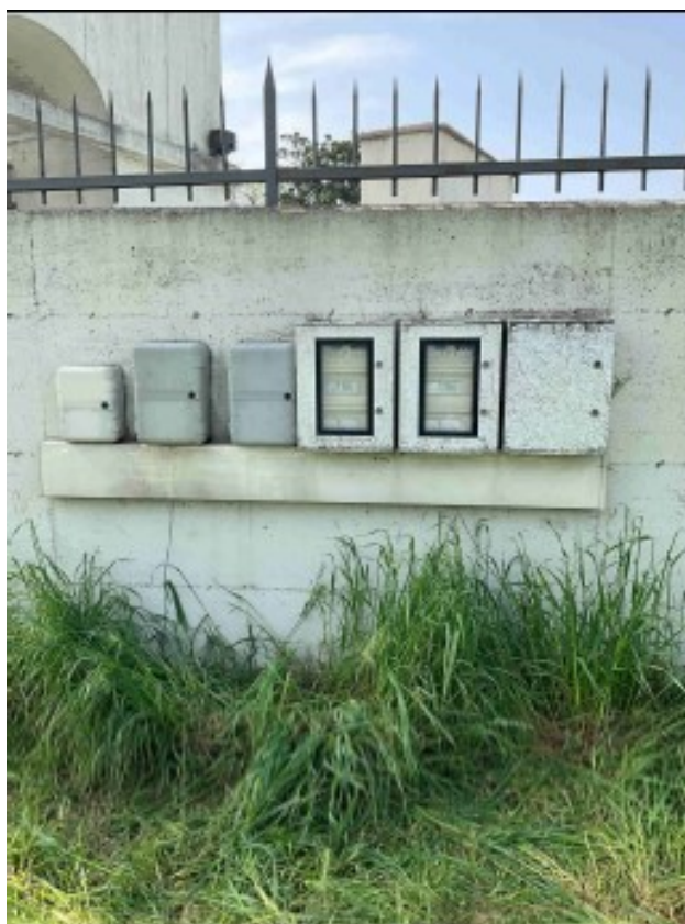
FOTOGRAFIA 2 : QUADRI ELETTRICI DIETRO NICCHIA CONTATORI NEL GIARDINO LOTTO 1
