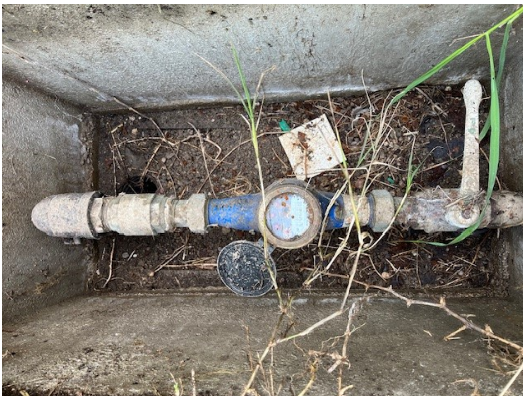
FOTOGRAFIA 6 : CONTATORE ACQUA ESISTENTE IN POZZETTO ESTERNO AL MURO DI RECINZIONE LUNGO VIA PAROLARA
