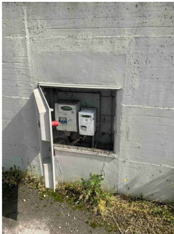
FOTOGRAFIA 1 : CONTATORI IN NICCHIA COMUNE NELL'INGRESSO COMUNE
