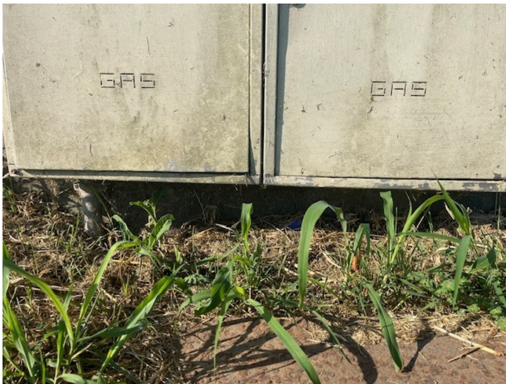
FOTOGRAFIA 5 : CASSETTE DEL GAS - PARTICOLARE ALLACCIO
