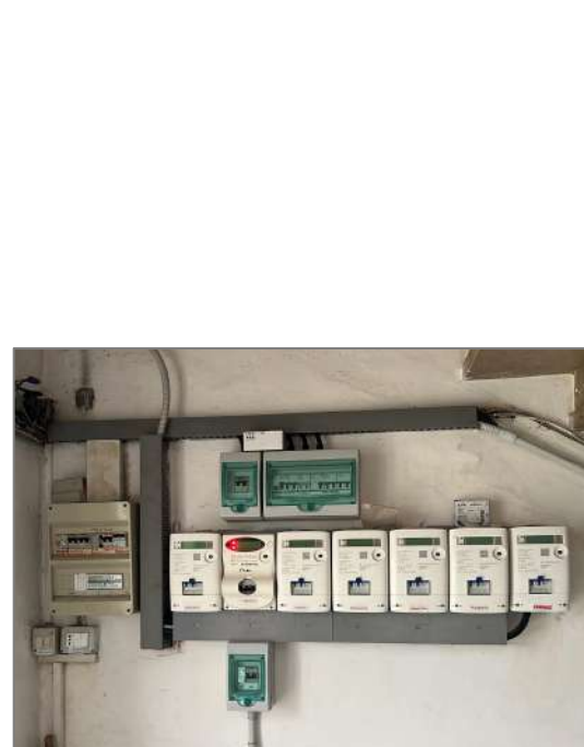
30. Contatori energia elettrica
