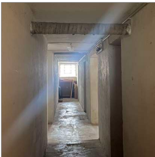
34. La tubazione - tratto nel corridoio
