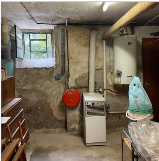
23. Caldaia e scaldacqua sanitaria (subalterno 4)
