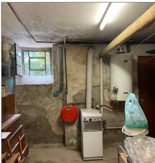
35. La tubazione - arrivo nella cantina in uso all'Esecutato
