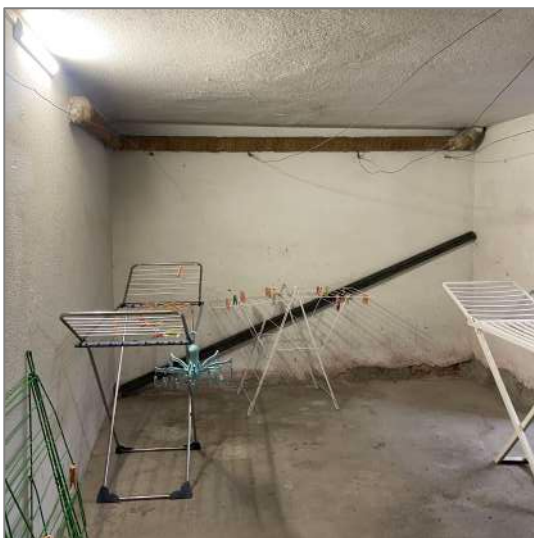
33. La tubazione - tratto nel vano comune
