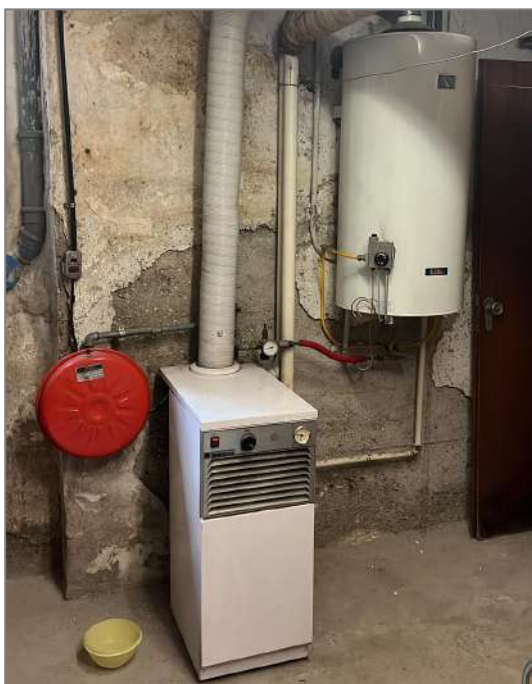
29. Caldaia e scaldacqua (subalterno 4)
