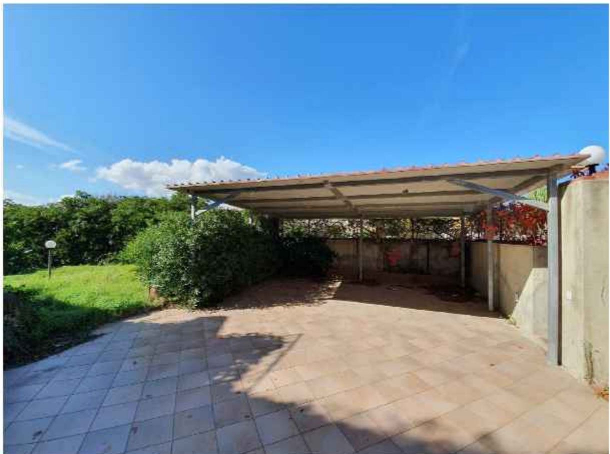
Foto 02 — Vista tettoia abusiva
